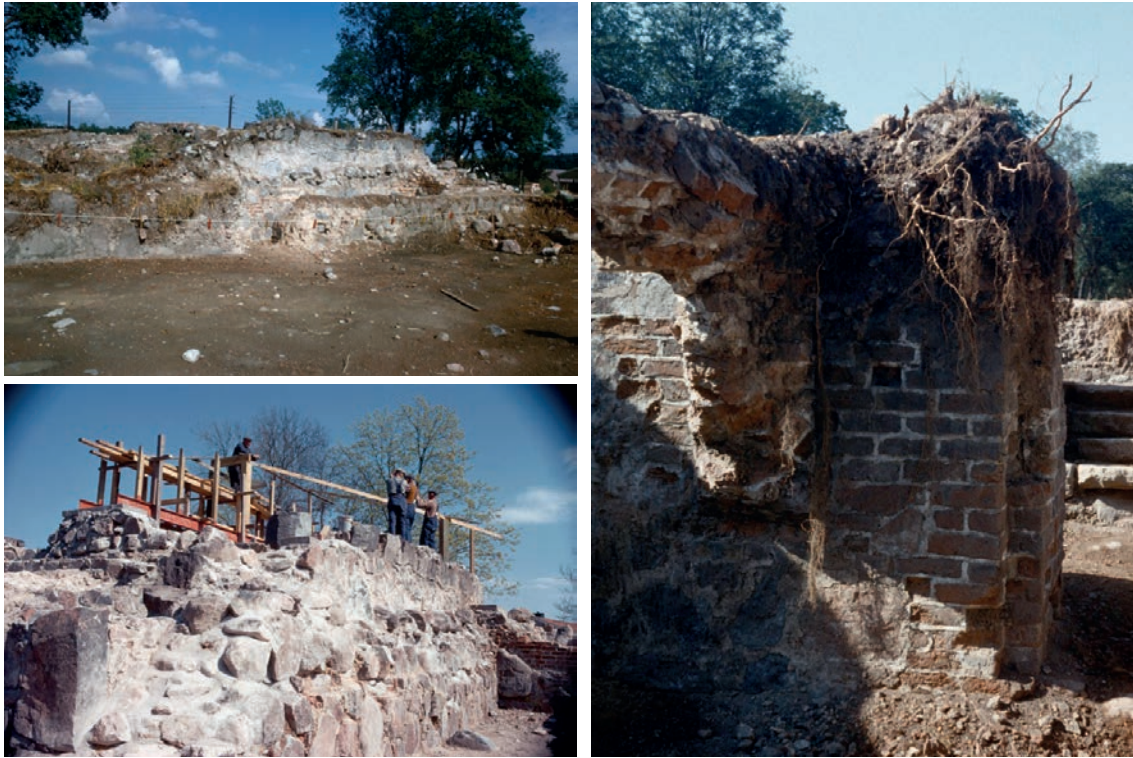
Figur 6 a-c. Vid de arkeologiska undersökningarna 1967-72 frilades hela borgruinen. Taket sattes upp 1969. Foto: Alf Nordström och Albert Read, Stockholms läns museum CC BY-ND-NC
