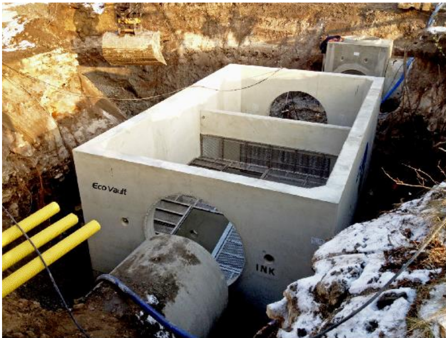
Figur 4: Dagvattenmagasin av betong för filterinsats.
