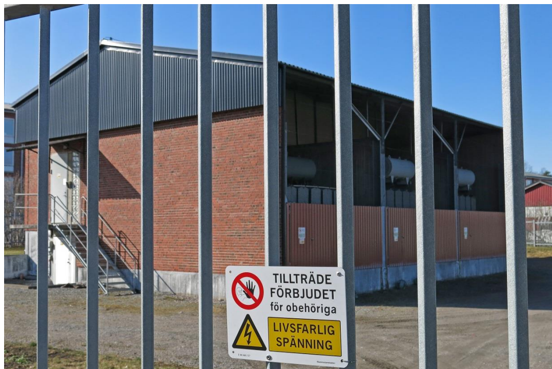
Transformatorstation väster om Storängsvägen.
