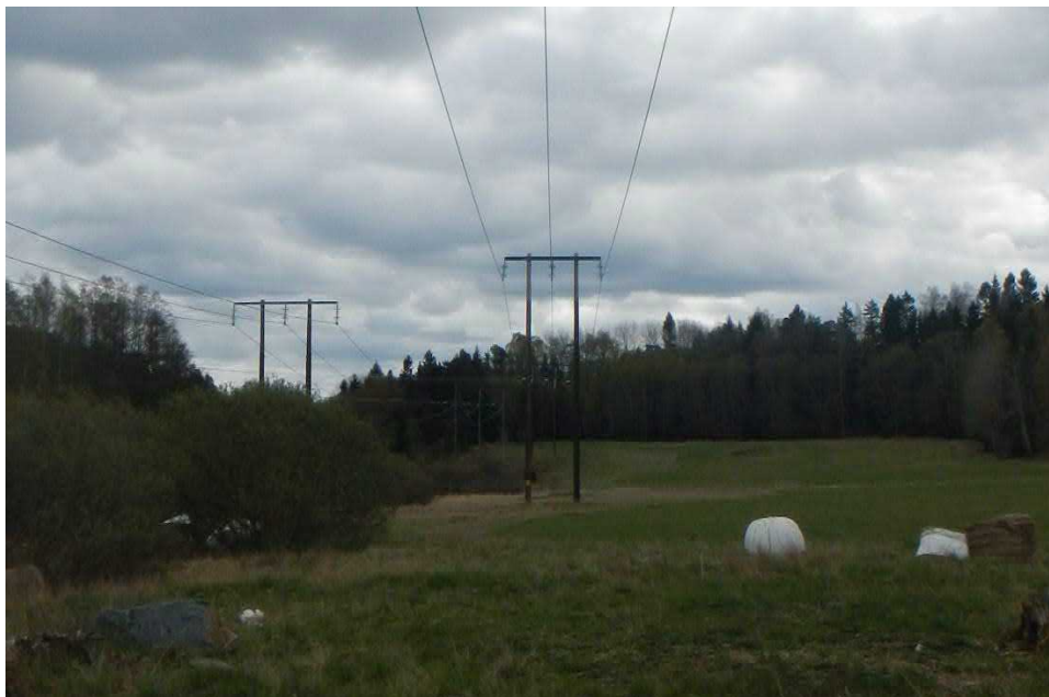
Figur 3. Befintlig ledning i portalträstolpe. Till vänster syns en annan parallellgående ledning.
