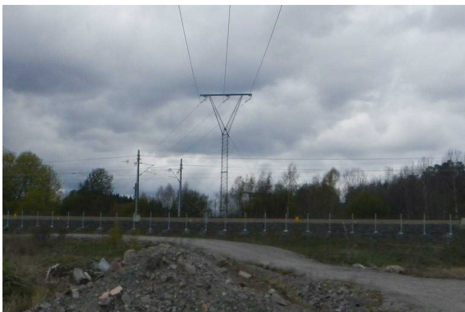
Figur 4. Befintlig ledning korsar Roslagsbanan i enbent stålstolpe med horisontellt placerade faslinor.
