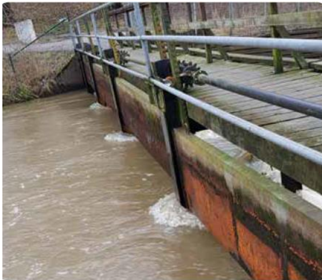
Figur 12. Regleringsluckorna och dess synliga maskineri. ( Slussholmen Antikvarisk utredning och konsekvensanalys ).
